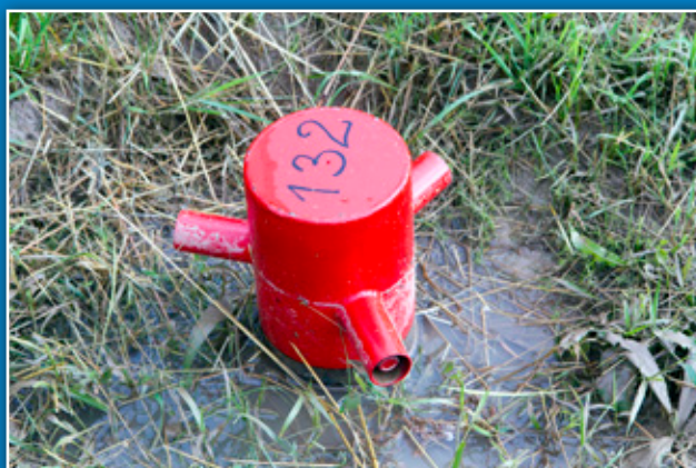
Piezometr nr 132 służący do pobierania próbek wody
