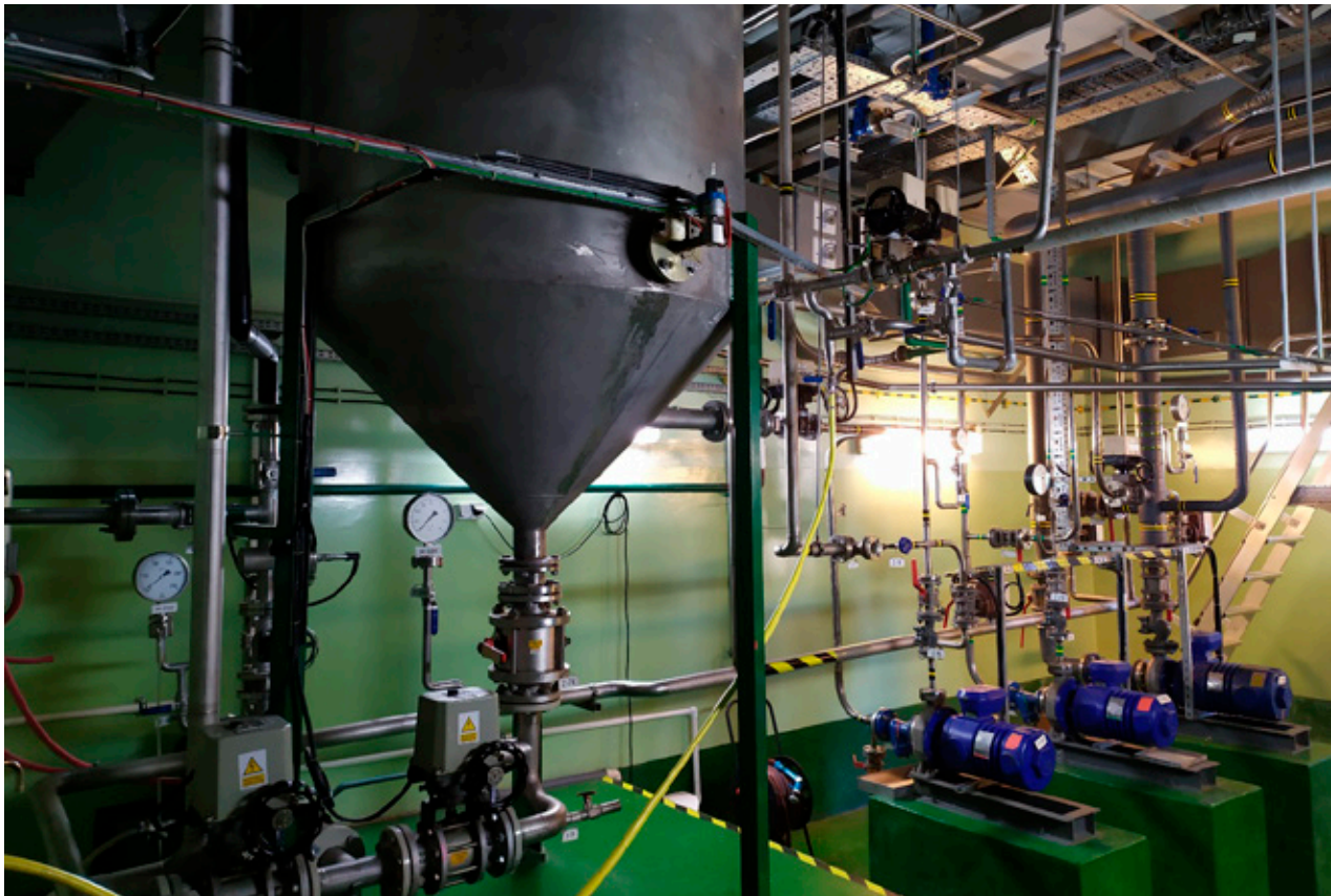
Fot. 5. Instalacja wyparna poziom, 0' (fot.KSOP) Photo 5. Level, 0' of evaporative installation
